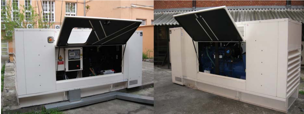
5. ábra. Az udvar betonján elhelyezett áramfejlesztő elől- és hátulnézeti képe
