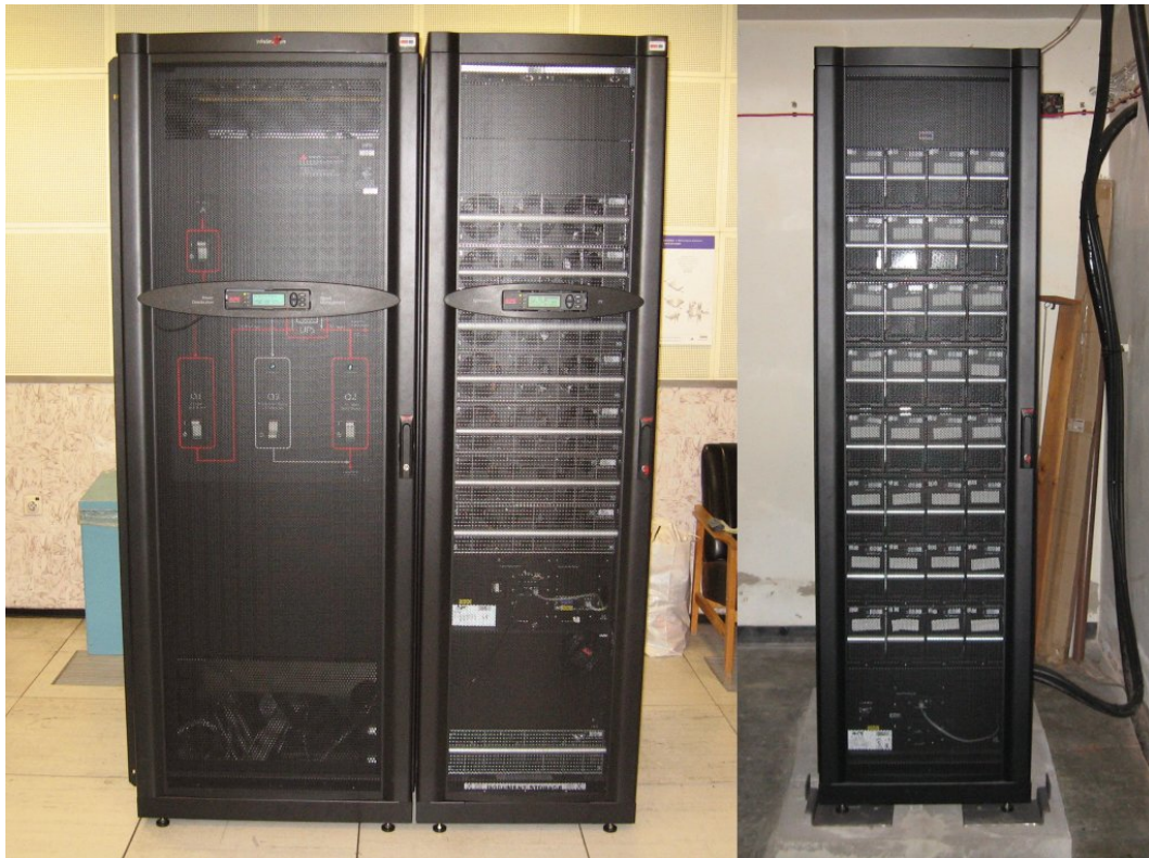
3. ábra. A telepített Symmetra UPS
